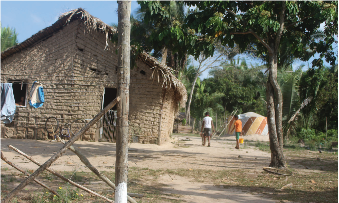
Los cimientos de las casas de Mutum II sufren la trepidación cada vez que el tren pasa
